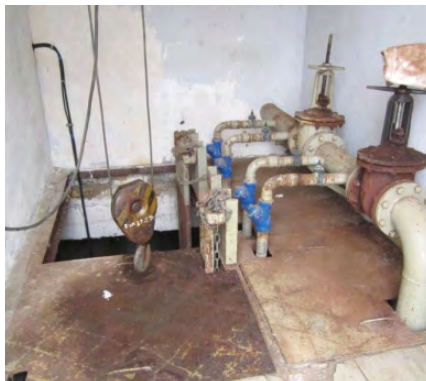
Головна каналізаційна насосна станція (вид зсередини)
