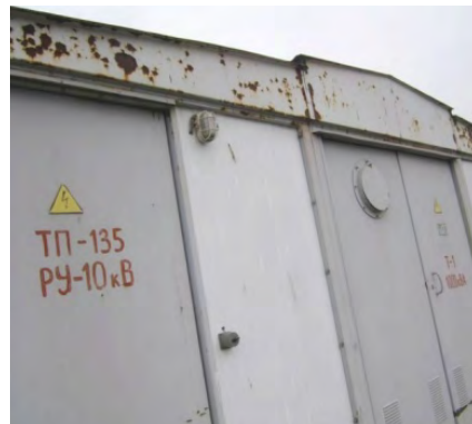
Трансформаторна підстанція ТП-135
