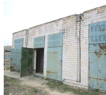
Трансформаторна підстанція ТП-570
